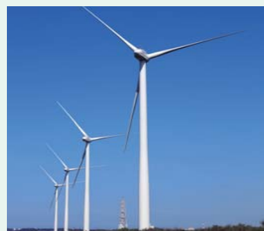
運転開始した三国風力発電所
