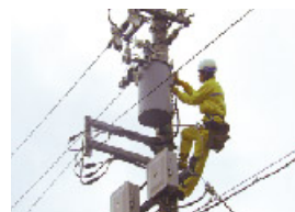
配電設備の保守
