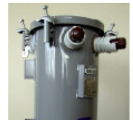
柱上トランス
