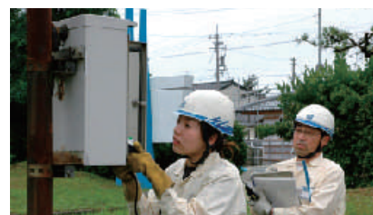
海水浴場周辺の電気設備点検
