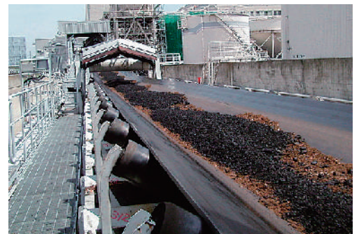
石炭ベルトコンベア(石炭と木質バイオマス混合状況)
