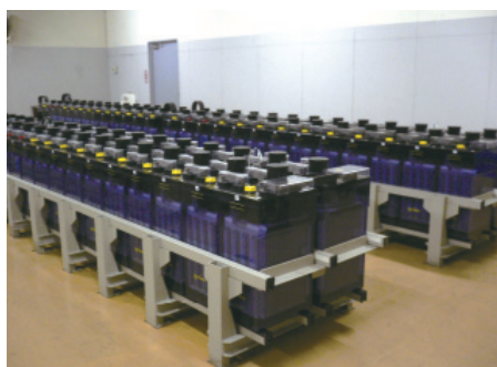
非常用電源として使用している鉛蓄電池
