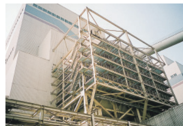
排煙脱硝装置(敦賀火力発電所)
