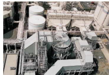
排煙脱硫装置(敦賀火力発電所)
