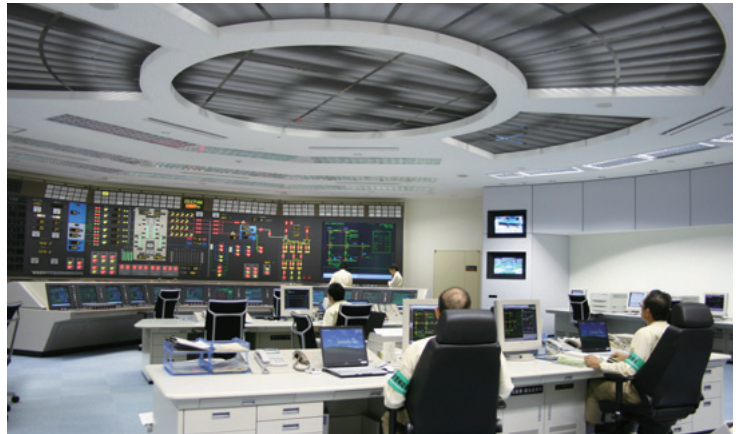
中央制御室(2号機)
