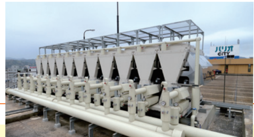
ヒートポンプ
