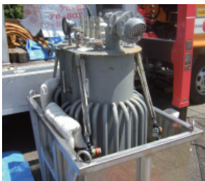
高濃度PCBを含む高圧変圧器
