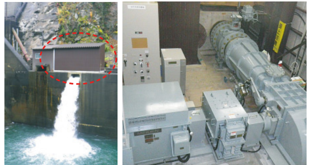
仏原ダム発電所(右：発電所内部)
