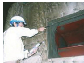
空調ダクトの風量測定
