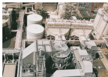
排煙脱硫装置(敦賀火力発電所)
