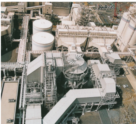
排煙脱硫装置(敦賀火力発電所)
