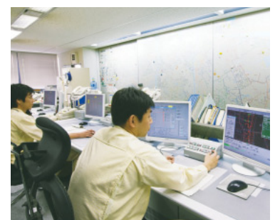
配電自動化システム
