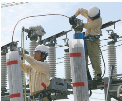
変電機器技能訓練
