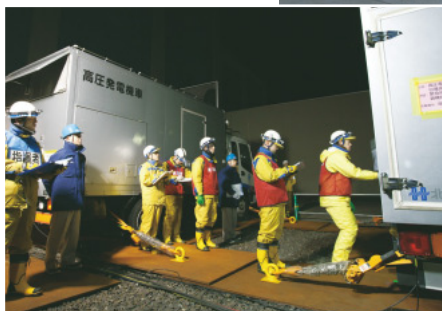
夜間での電源車による給電訓練
