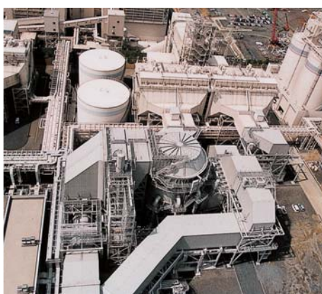
排煙脱硫装置(敦賀火力発電所)
