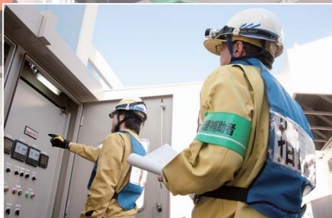
大容量電源車による給電訓練
