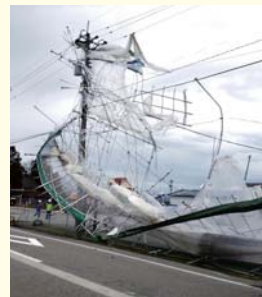
強風による配電線被害
