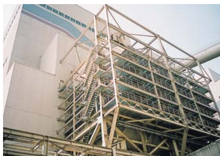
排煙脱硝装置(敦賀火力発電所)
