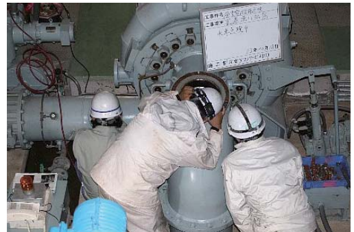
小水力発電所の水車外部点検作業
