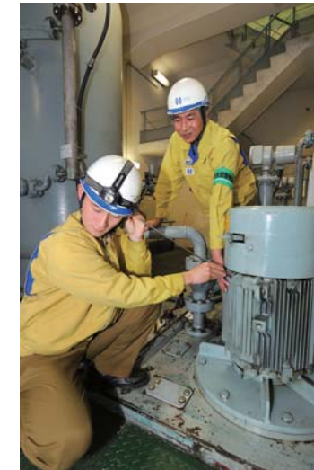
水力発電所での巡視点検
