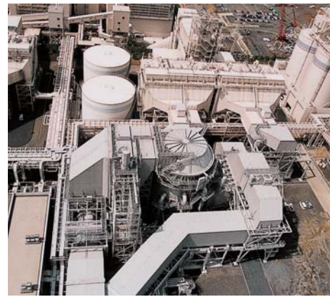
排煙脱硫装置(敦賀火力発電所)
