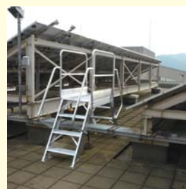
太陽光パネルを点検の際、ダクトを跨いでの転倒を防止するため階段を設置
