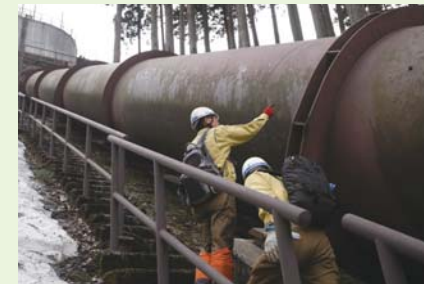
水力発電所での巡視点検
