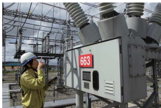
変電部門の女性従業員(変電所日常巡視)
