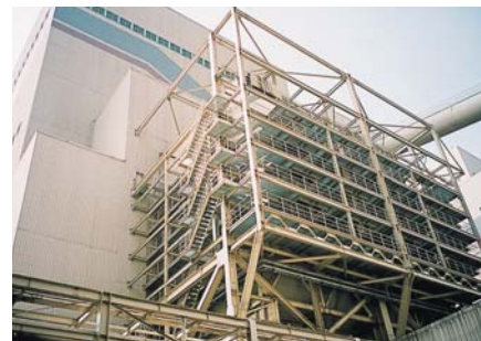
排煙脱硝装置(敦賀火力発電所)
