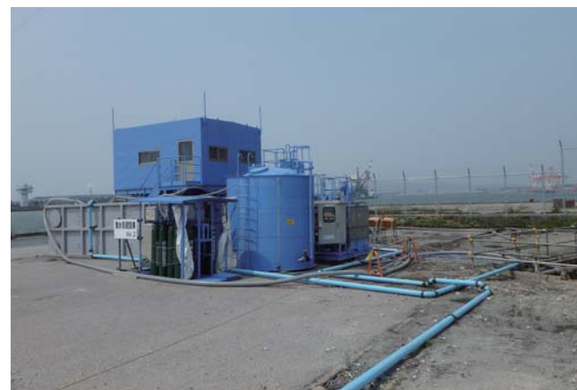
仮設排水処理装置の設置状況
