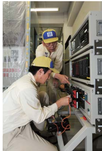
変電所での点検
