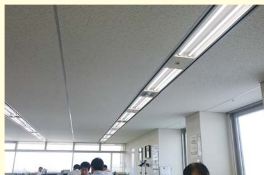
LED照明の導入
