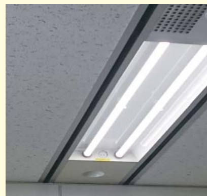
照明間引き(3本→2本)による省エネルギーの推進
