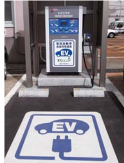
急速充電装置(小松支社)
