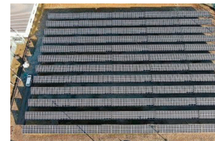
設置した太陽光発電所(1,024kW)
