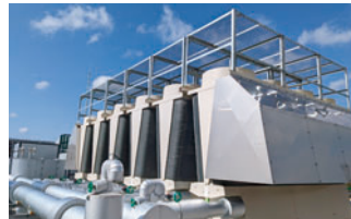
空調設備(ヒートポンプチャラー)
