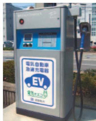
急速充電装置
