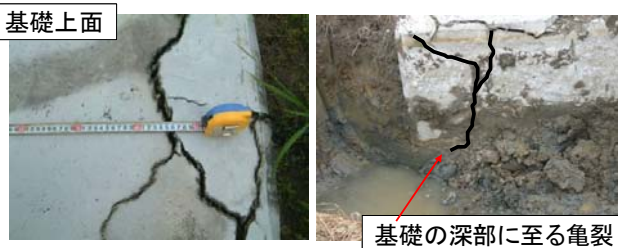
第1図 基礎に生じた亀裂の例
