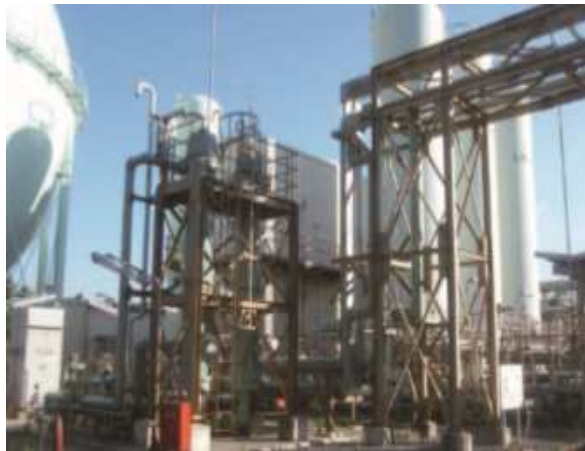
LNGサテライト
