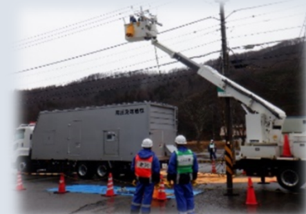
<大容量発電機車>
