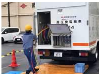
第八管区との電源供給訓練
