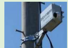
防犯カメラ設置
