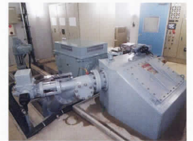
▲有峰ダム発電所 河川への維持放流水を活用した水力発電所
