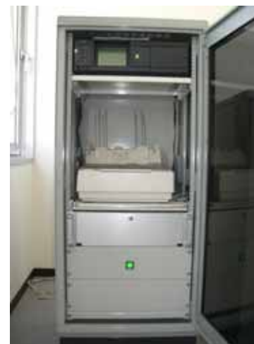
一斉呼出装置
