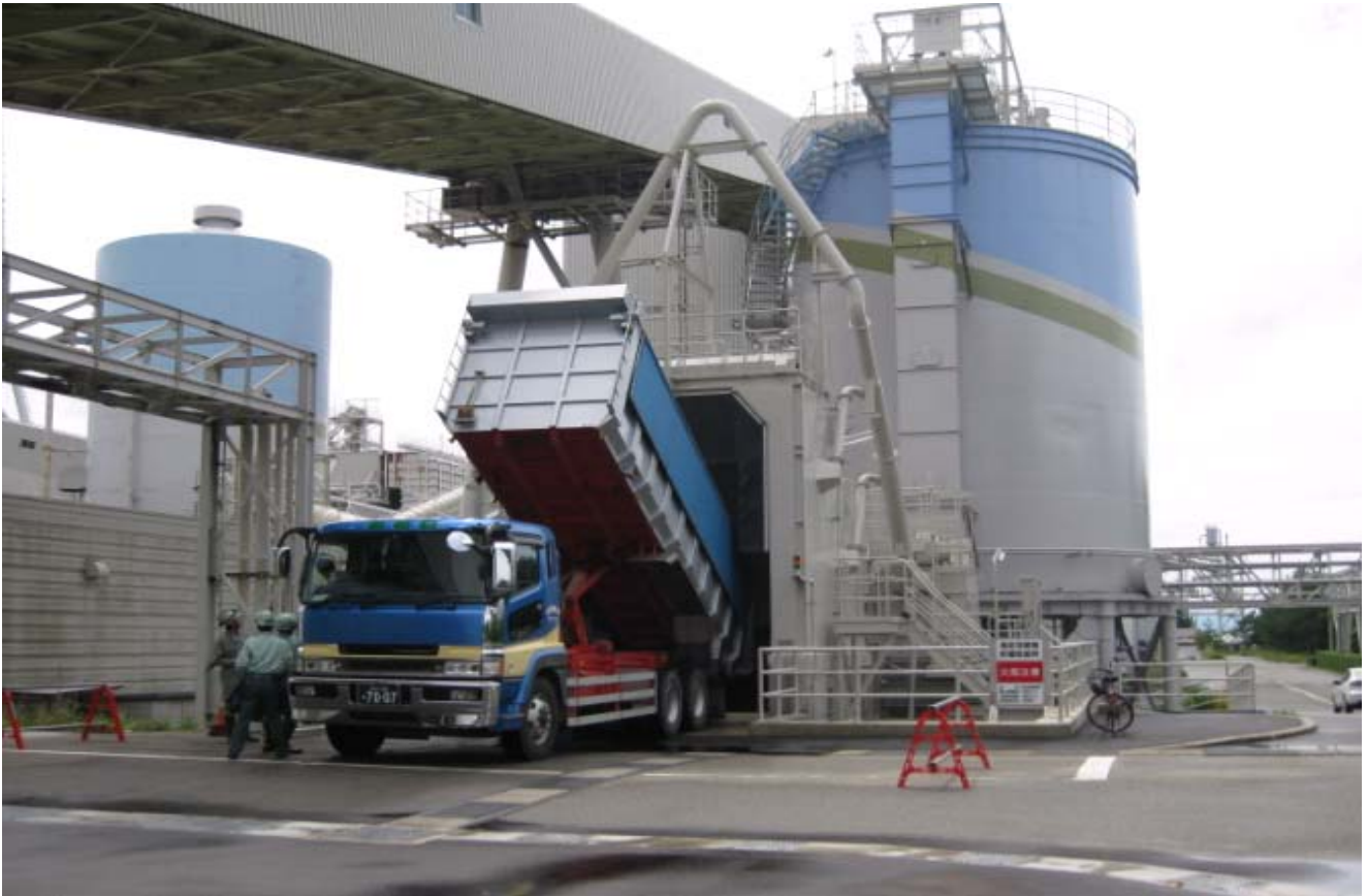
木質バイオマス受入・払出設備外観(バイオマス受入状況)
