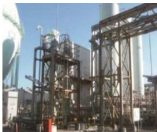
LNGサテライト
