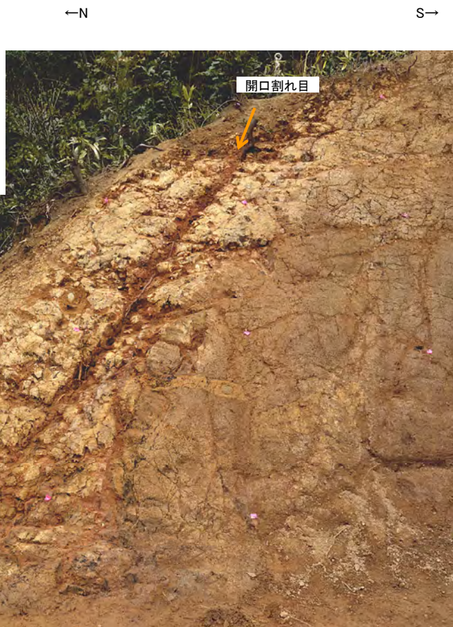
開口割れ目 上図写真範囲 写真(道路法面北端)
